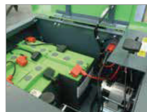
ALOJAMIENTO DE BATERÍAS
