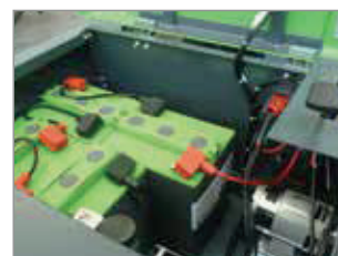
ALOJAMIENTO DE BATERÍAS
