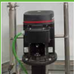
Bomba de agua
