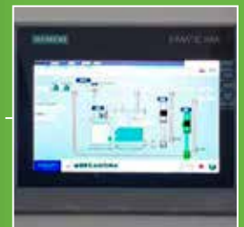
Pantalla de control HMI
