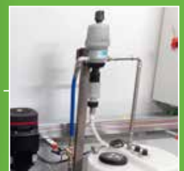
Sistema de dosificación
