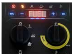
PANEL DE CONTROL CON INDICADORES LUMINOSOS AND DISPLAY
