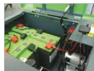
ALOJAMIENTO DE BATERÍAS (1280 E)
