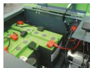
ALOJAMIENTO DE BATERÍAS (1250 E)
